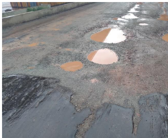
Pavimentação de uma das baias bastante desgastada pela ação das intempéries. São Luís, 15.01.2022.
