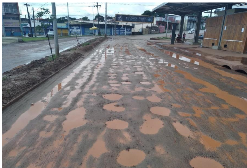
Figura 01 – Buracos no piso asfáltico, ao longo da terceira plataforma do Terminal
