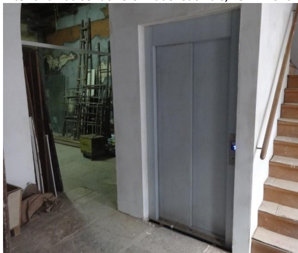
Elevador instalado na edificação. São Luís, 25.11.2020.
