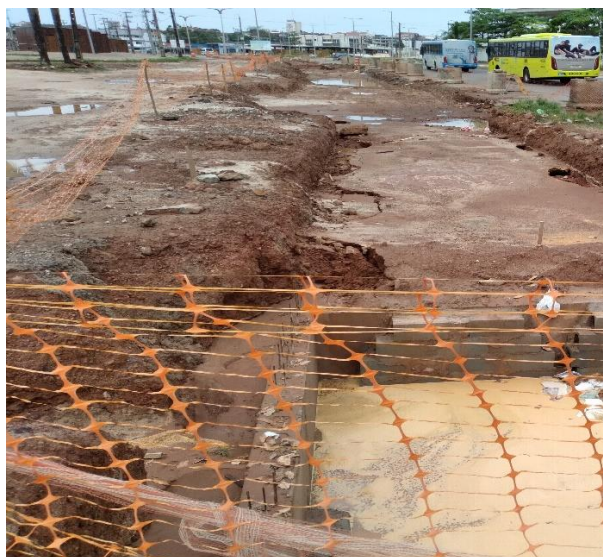
Avenida Vitorino Freire. Área junto à Avenida, interditada para execução de obra de drenagem. São Luís, 26.12.2021.
