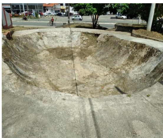
Pista de Skate do Skate Park se deteriorando após a suspensão da execução da obra. São Luís, 10.07.2021.
