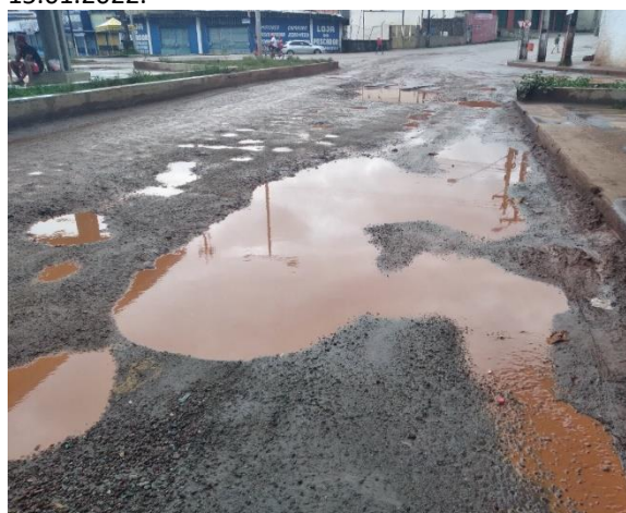
Buracos na plataforma de embarque da segunda baia. São Luís, 15.01.2022.
