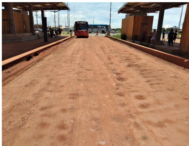
Primeira baía sem capa asfáltica. São Luís, 12.03.2022.
