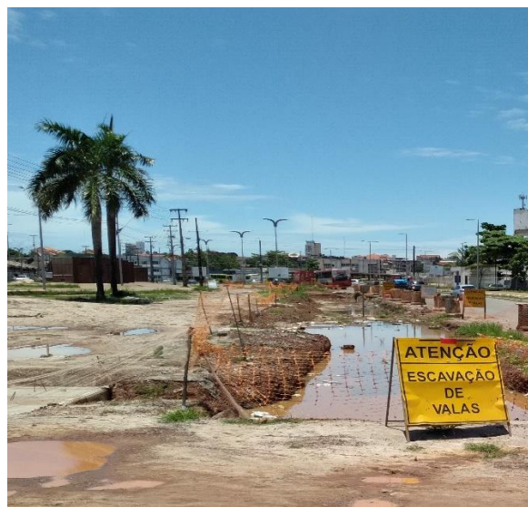
Mesma área interditada, sem indicativo de solução para o problema detectado. São Luís, 12.03.2022.
