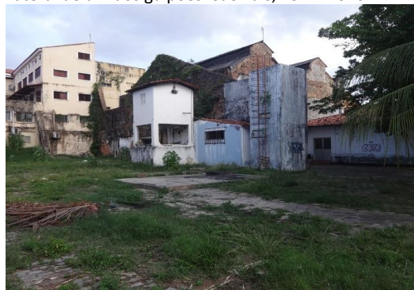
Estrutura a ser restaurada. São Luís, 25.11.2020.
