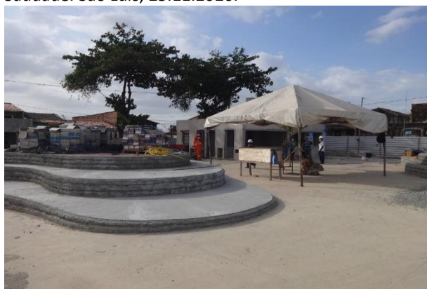
Outros materiais de construção empilhados na obra da Praça da Saudade. São Luís, 25.11.2020.
