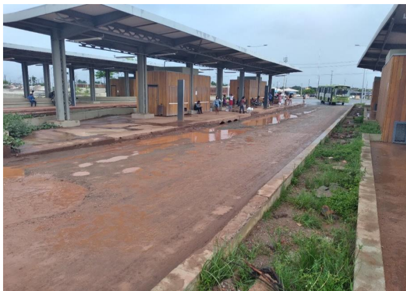
Figura 02 – “Crateras” no piso asfáltico, ao longo da segunda plataforma
