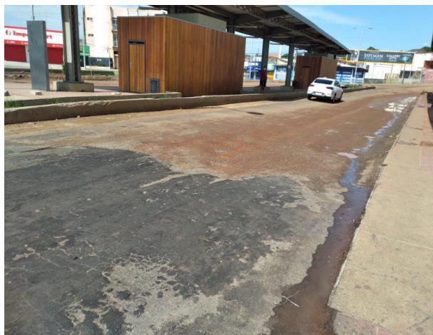
Segunda baia praticamente sem “capa asfáltica”. São Luís, 02.01.2022.
