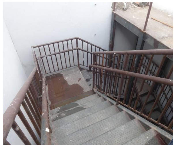
Escada instalada por exigência do Corpo de Bombeiros. São Luís, 25.11.2020.
