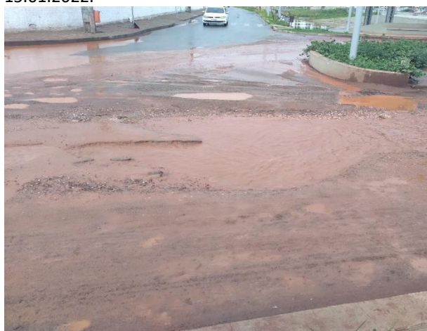
Buraco imenso na saída da segunda pista do Terminal. São Luís, 15.01.2022.
