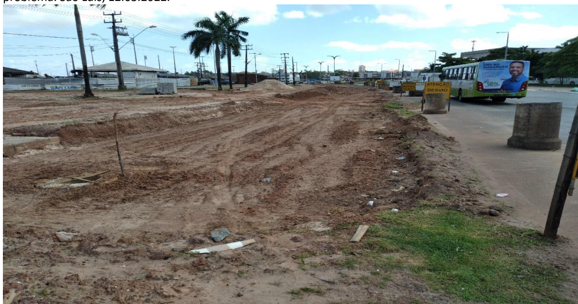
Área interdita para obras, sem expectativas para resolução do problema apontado. São Luís, 14.06.2022.
